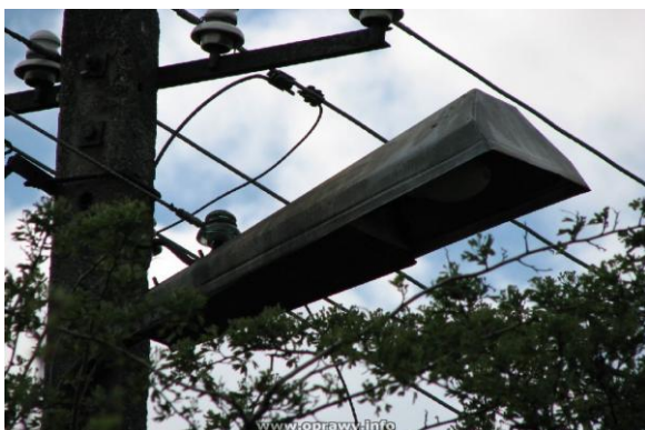
Oprawa typu OUR-3kl. Blaszana bez odbłyśnika ze źródłem rtęciowym. Zawieszona pod linią. Praktycznie bezużyteczna oświetleniowo.
